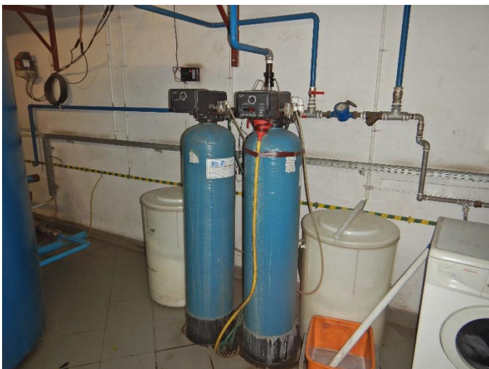
Fot. 8 Widok stacji uzdatniania wody do regeneracji złoża
